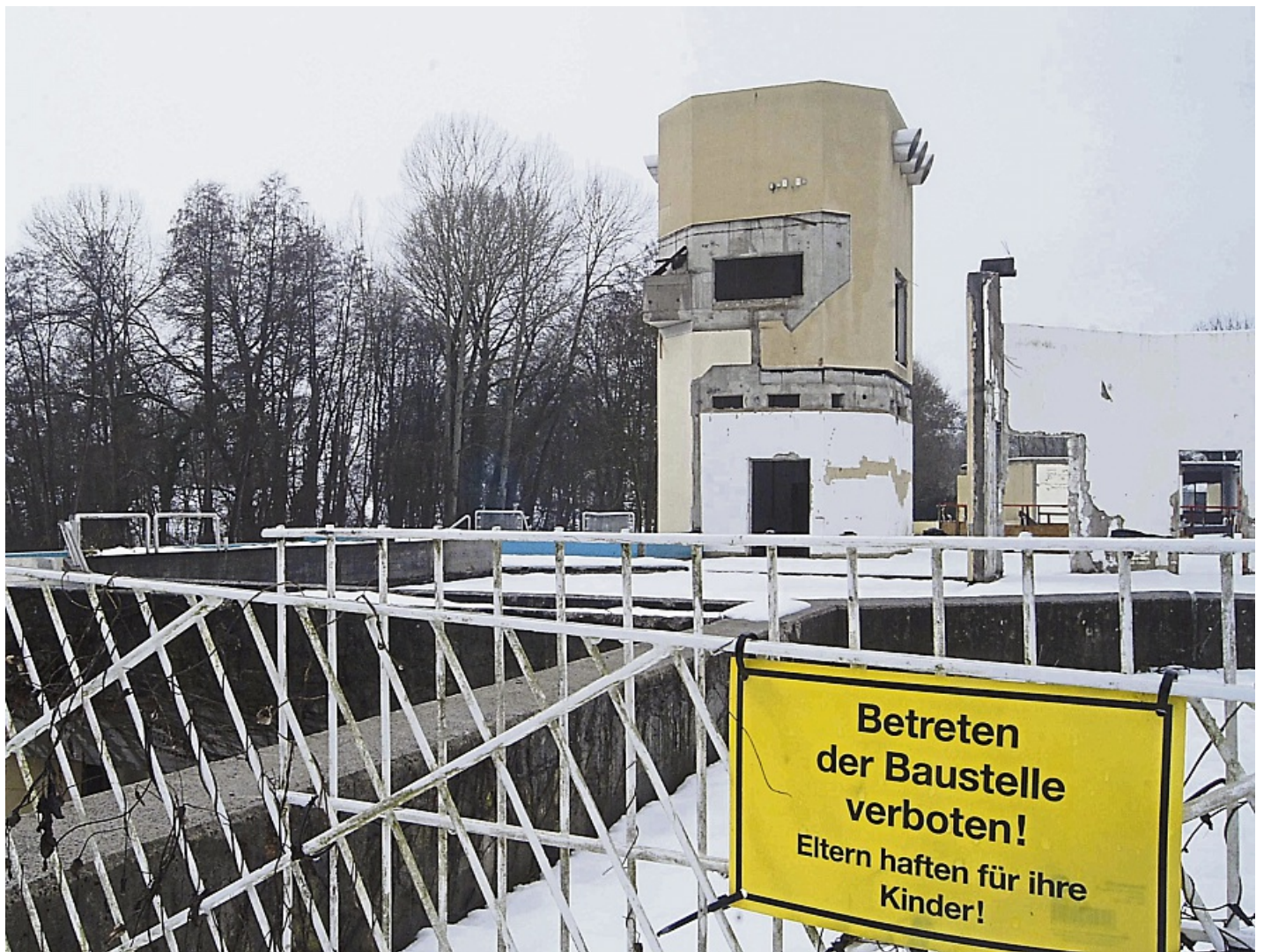
Als Bauruine zeigt sich die Therme in Bad Salzhausen nach dem Teilabriss. Bisher hat der Investor keinen neuen Bauantrag gestellt. OLIVER POTENGOWSKI
